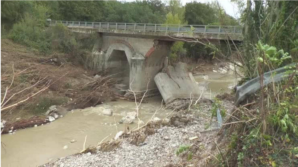
Figura 2 Crollo Pila ponte Circello esondazione fiume Torti 2015
